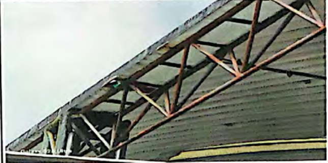
Foto 2: El canal del techo de la cancha está picado necesita sustitución.
