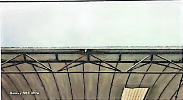
Foto 1: El canal del techo de la cancha está picado necesita sustitución.
